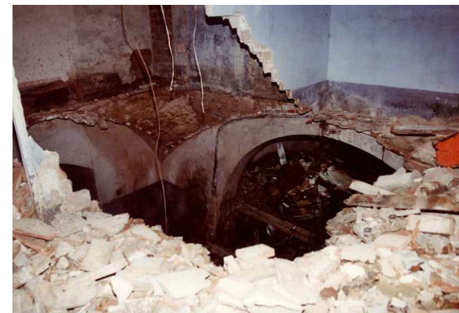
FOTO 9 - Rif. A - Particolare delle volte interne crollate
