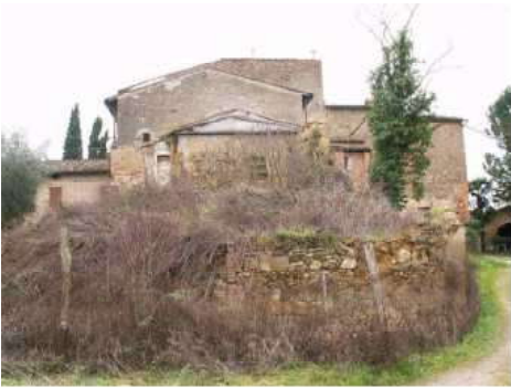
FOTO 1 - Rif. A' - Veduta della porzione crollata
