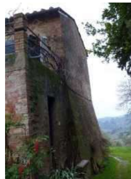
FOTO 6 - Rif. A - parte in aggetto sul fronte principale
