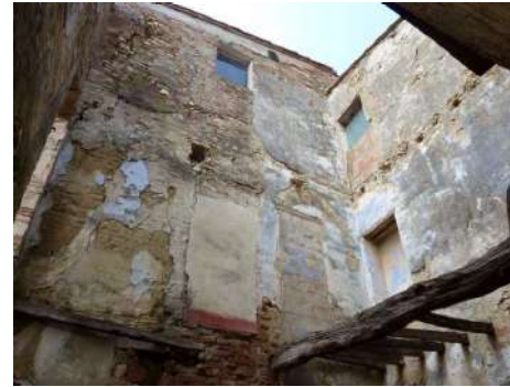
FOTO 3 - Rif. A - l'interno del volume con parti crollate
