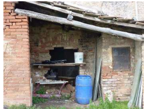
FOTO 8 - Rif. A - particolare del forno
