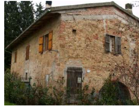
FOTO 3 - Rif. A - Particolare della gronda, evidente il rialzamento
