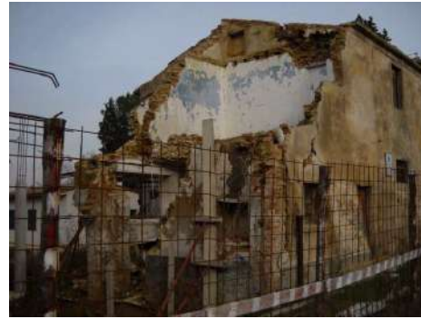
FOTO 2 - Rif. A' - porzione crollata
