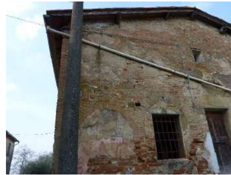
FOTO 3 - Rif. A - particolare del fronte timpanato con gli elementi incongrui in facciata
