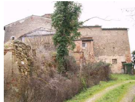
FOTO 16 - Rif. A' - veduta lato Nord della porzione crollata
