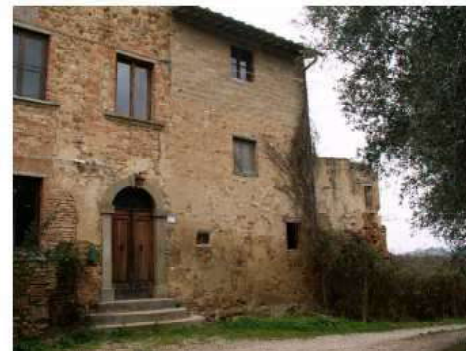
FOTO 9 - Rif. A - Fronte lato sx con porzione crollata
