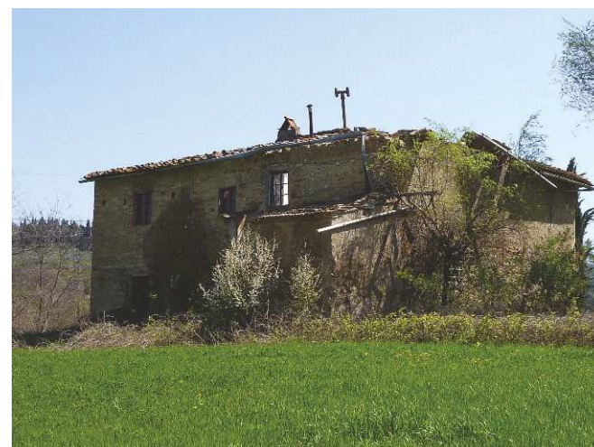
FOTO 2 - Rif. A - L'edificio con alcune parti crollate
