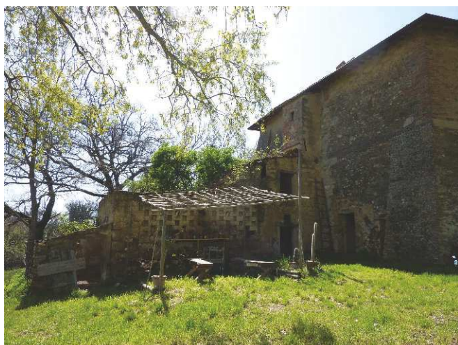
FOTO 4 - Rif. A - Parte dei rustici crollati
